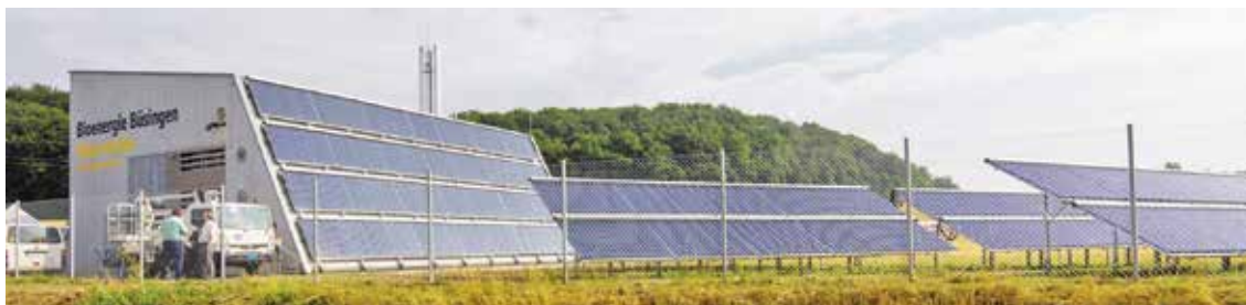
Energiecentrale op houtsnippers en thermische zonne-energie. https://de.wikipedia.org
